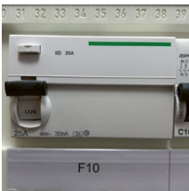
Fehlerstrom-Schutzeinrichtungen (RCD) schützen vor elektrischem Schlag und Bränden. Man erkennt sie an der Test-Taste.
