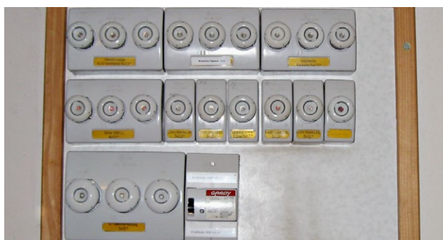
Distribuzione elettrica (immagine Suva)
