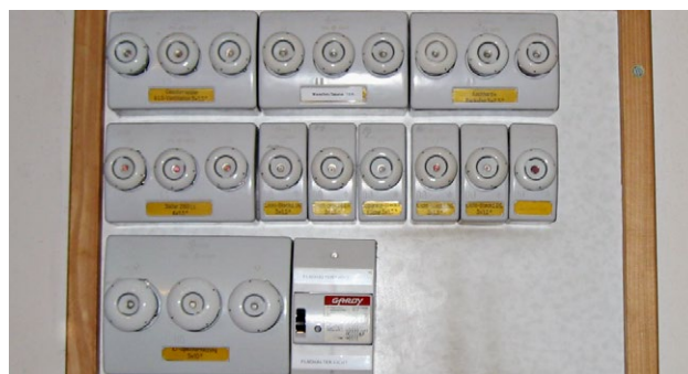
Distribuzione elettrica (immagine Suva)
