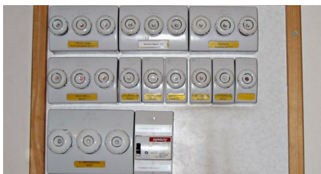
Distribution électrique (photo Suva)
