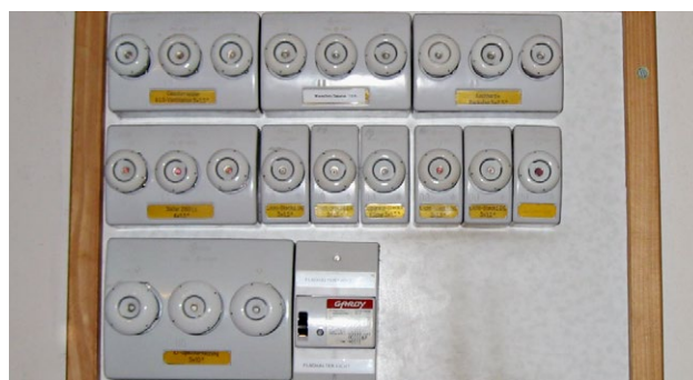
Distribution électrique (photo Suva)
